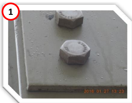
工地現場採用不銹鋼栓，與合約規定不符。
