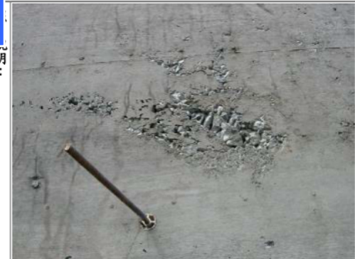
不合格改善照片
