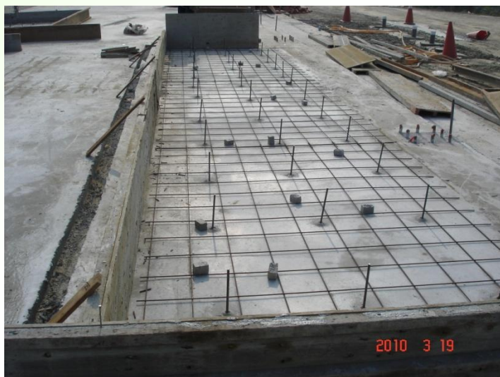
保護層不足, 墊塊未放置正確位置
